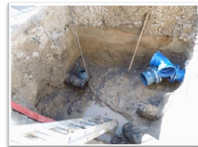
Raccordement au réseau
